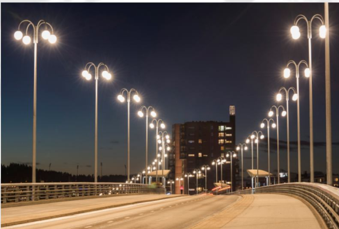
Jyväskylä, Kuokkalan sillan katuvalaistuksen saneeraus 2013 (Kuva Jani Salonen, Valon kaupunki Jyväskylä)
